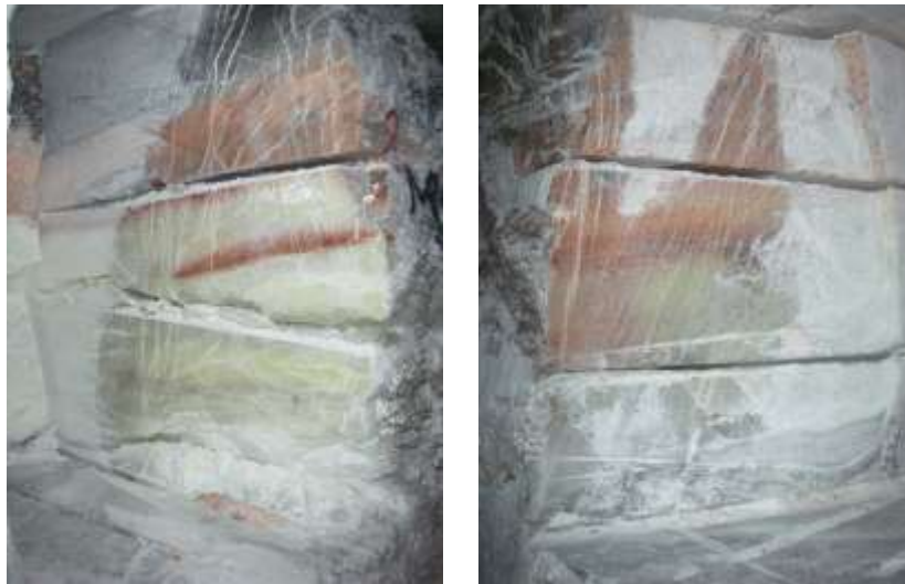
Abb. 7-2. Durchfeuchtete Konturzone entlang Rissstrukturen um einen Streckenhohlraum im Salzgebirge
